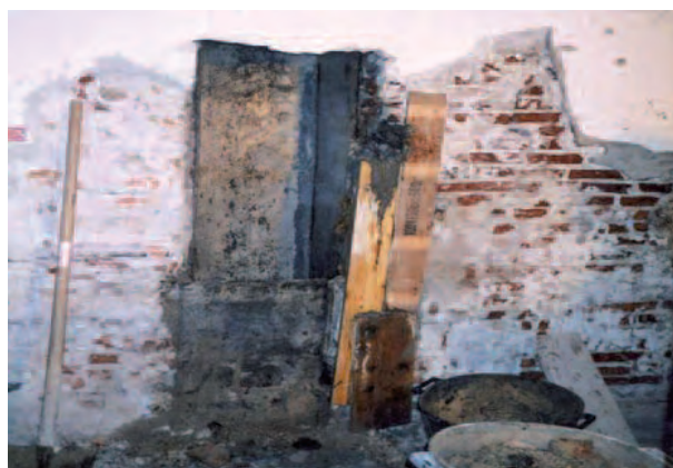
foto 13 - Una condotta, fasciata in ardesia, per il prelievo di acqua ad usi domestici dalla cisterna posta sotto il piano fondi. Appartamento al primo piano in via dei Giustiniani n° 19.
