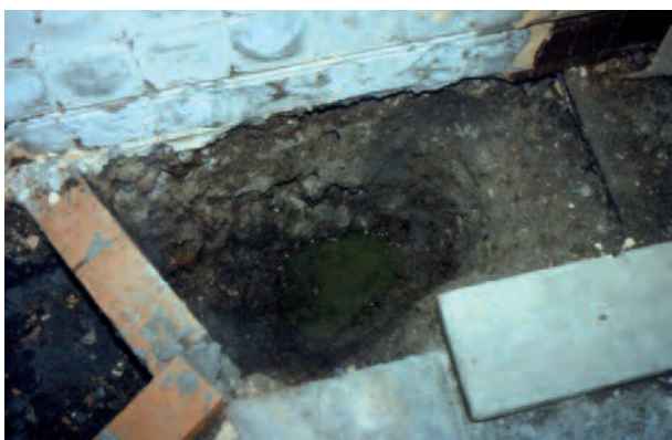
foto 10 - Presenza di acqua di falda a piano terra del civico n° 12 di via di Ravecca.
