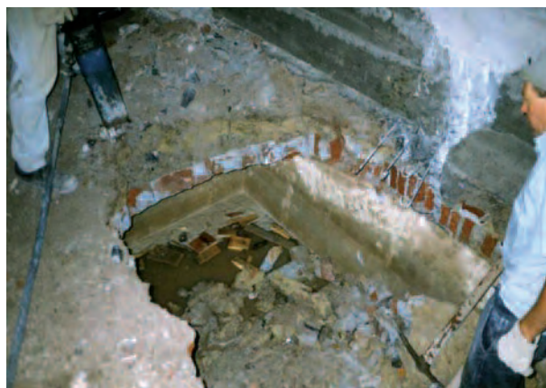
foto 11 - Una cisterna al piano fondi del civico n° 8 di via della Fava Greca venuta alla luce durante i lavori di ristrutturazione del fabbricato.
