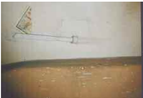
foto 6 - La "testa" di una catena che attraversa due appartamenti contigui in vico Coccagna n° 16.
