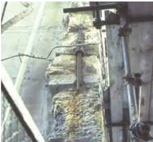
foto 5 - Primo piano del bolzone di una catena messa in opera, durante la costruzione, nella parete portante di un edificio in via di Ravecca.
