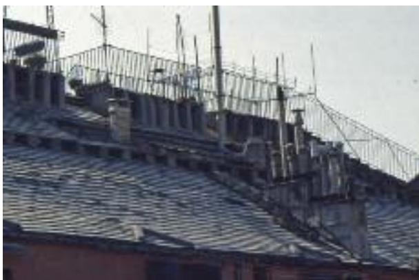
foto 9 - Pilastri in mattoni a sostegno di terrazzi posti sul colmo di una copertura.
