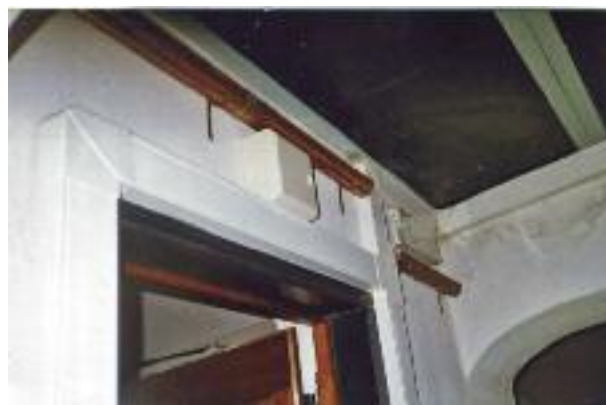
foto 11 - Un esempio di "artistica grondaia interna" per raccogliere l'acqua che filtra dal terrazzo di copertura in un corridoio dell'ex dipartimento DIPARC ad Architettura dove si è voluto ripristinare l'antica tecnica di appoggio diretto sulla falda del tetto vista nella precedente figura n° 10.
