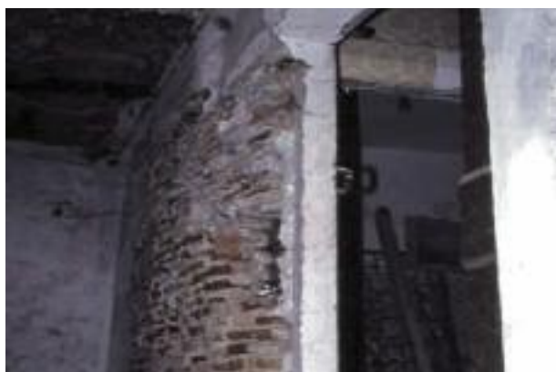
foto 14 - Parete in mattoni di un corpo scala, vistosamente deformata per carico anomalo in via di Ravecca n° 10.
