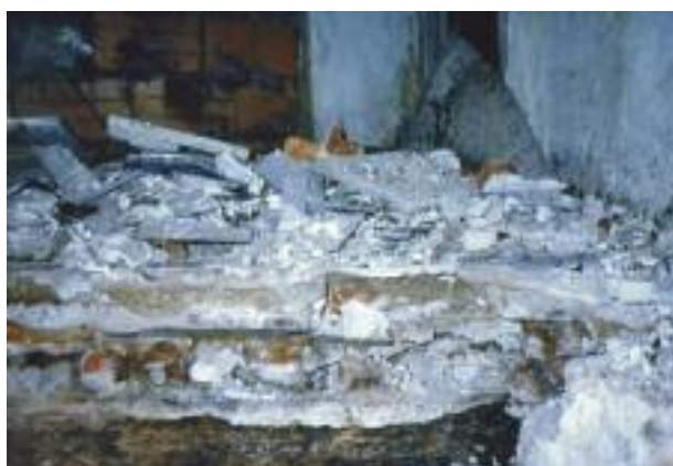
foto 22 - Strati di materiale sovrapposti su un solaio ligneo senza rinforzare la struttura sottostante.
