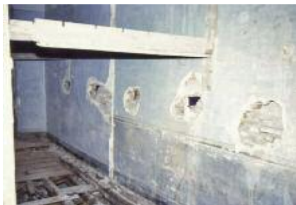
foto 23 - Esempio di come si sia “approfittato” della parete a comune con un vicino di casa, evidentemente “assente”, per appoggiarvi un nuovo solaio in profilati metallici.
