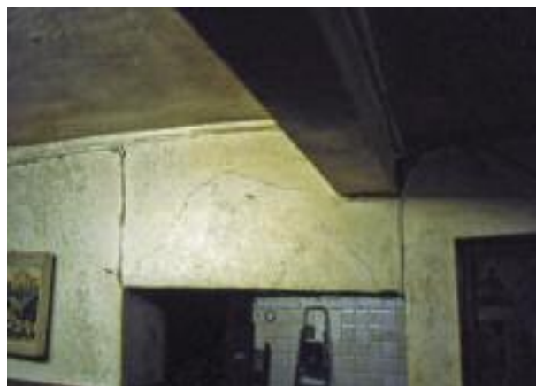
foto 24 - La presenza di una lesione ad arco segnala l’indebolimento della parete non sorretta sul vuoto da un’adeguata piattabanda; via di Ravecca n° 10.
