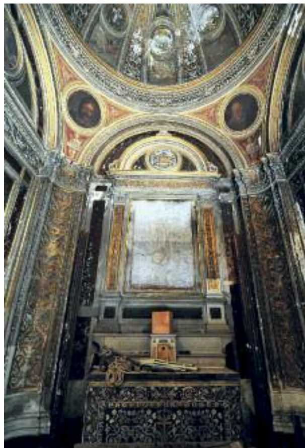
Cappella di San Pietro, l'aspetto degradato prima del restauro
