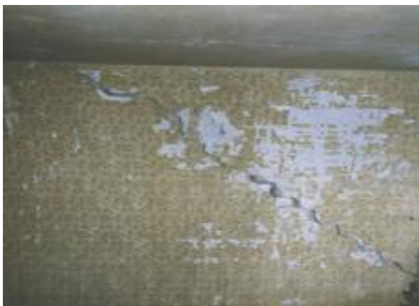
foto 17 - Lesione da taglio in un tramezzo caricato impropriamente dal solaio soprastante. Appartamento in vicolo Noli n° 1.
