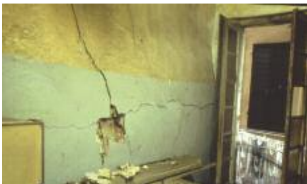
foto 9 - Magazzino del bar al piano ammezzato dell'edificio di via di Ravecca n° 12. Un tratto della parete portante a comune con il civ. n° 14 e la sua notevole deformata come si presentava ad un primo sopralluogo nel marzo del 1993.
