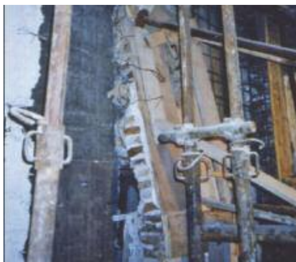
foto 8 - Vistoso effetto arco su di un tramezzo cui è venuto a mancare l'appoggio sul solaio. Edificio nella piazza dei Truogoli di S. Brigida (Ge).
