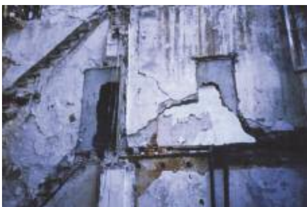
foto 8 - Vistoso effetto arco su di un tramezzo cui è venuto a mancare l'appoggio sul solaio. Edificio nella piazza dei Truogoli di S. Brigida (Ge).
