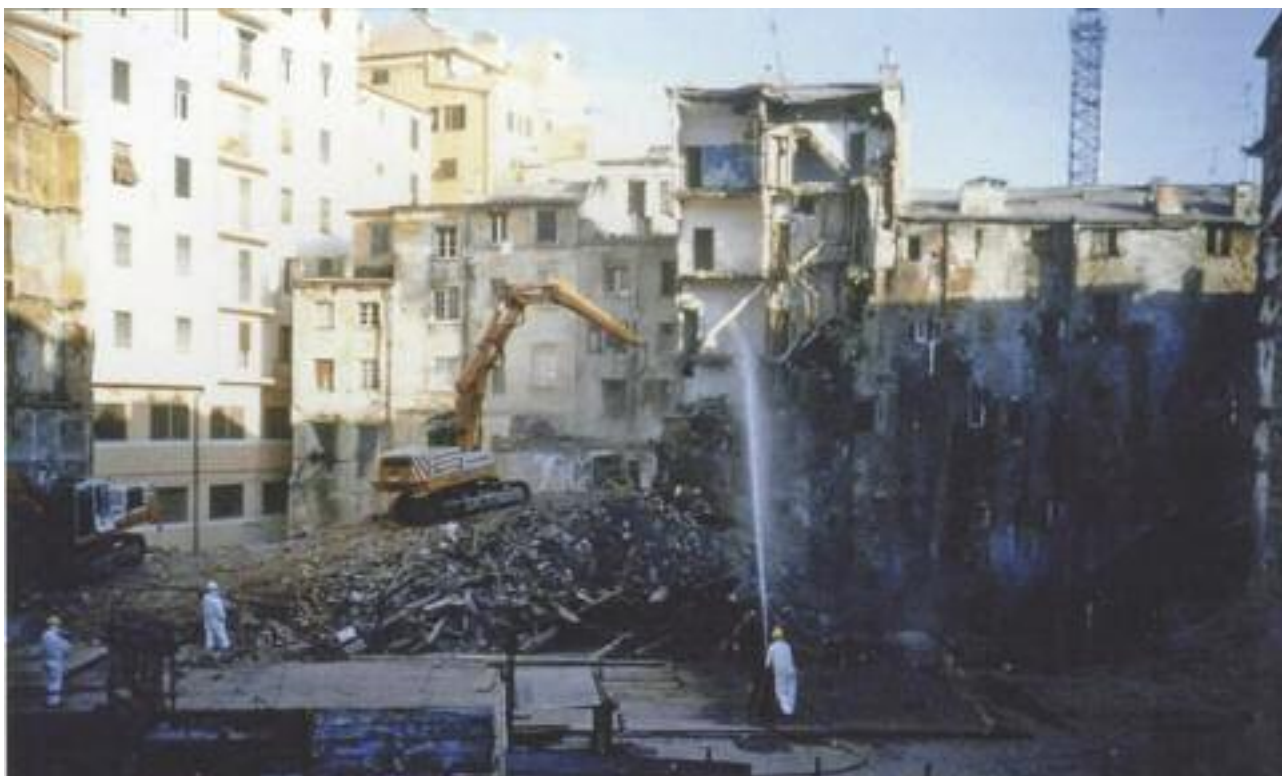
foto 4 – Fasi della demolizione di parte della schiera di edifici tra vico Tacconi e p.zza Marinelle.
