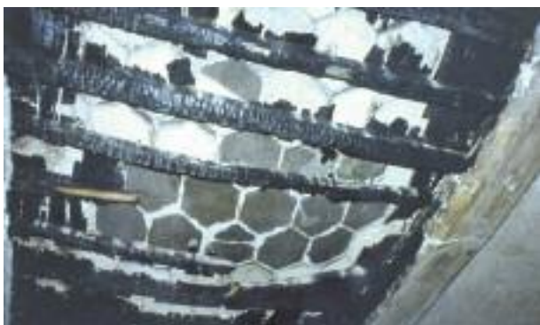
foto 1 - Le conseguenze di un fortuito incendio in vico di Coccagna n° 14 (sopralluogo del 1996).
