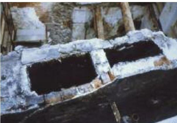
foto 17 - Accoppiata di due condotte per i fumi che di fatto riduce non di poco la portanza della parete al cui interno sono state ricavate.
