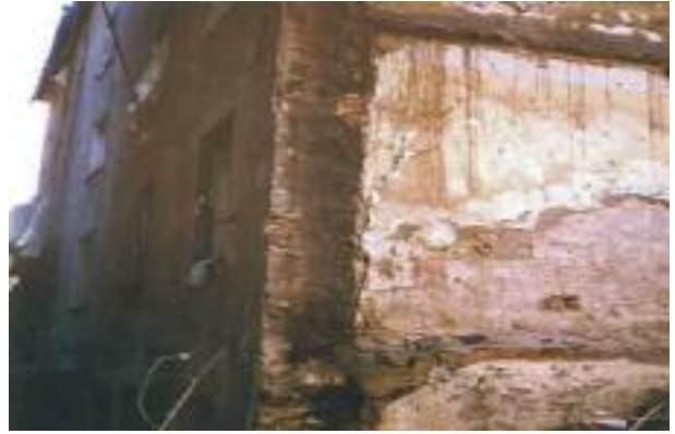
foto 18 - La traccia ben evidente di un vecchio camino all'interno di un muro di facciata dell'edificio crollato nel 1998 in vico Tacconi.
