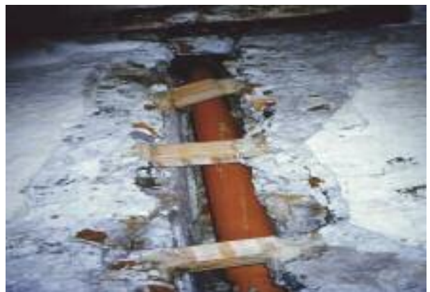
foto 20 - La profonda crena, creata per alloggiare un grosso tubo in plastica, intacca non poco una parete portante all'interno di un appartamento in Prè.
