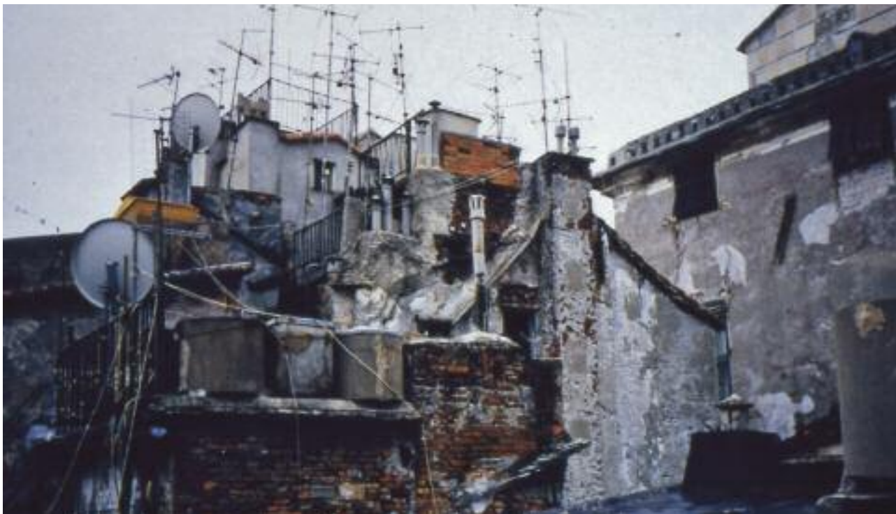
foto 12 - Una delle tante sopraelevazioni staticamente problematiche su un edificio del "Ghetto"
