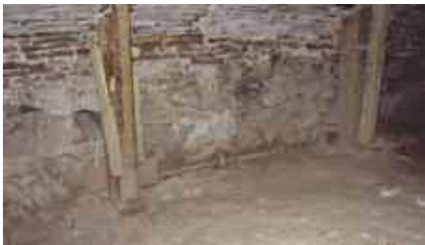
foto 13 – Il bolzone capochiave di una delle sette catene messe in opera da Simone Cantoni per rendere solidale la vecchia facciata su Piazza Matteotti con i nuovi contrafforti.
