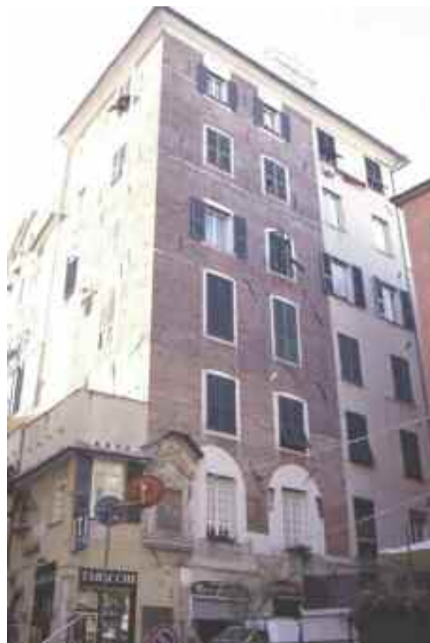
foto 4 - Ben visibili, sulle due facciate di un edificio di Porta Soprana i bolzoni delle catene metalliche affogate nelle pareti durante la costruzione.
